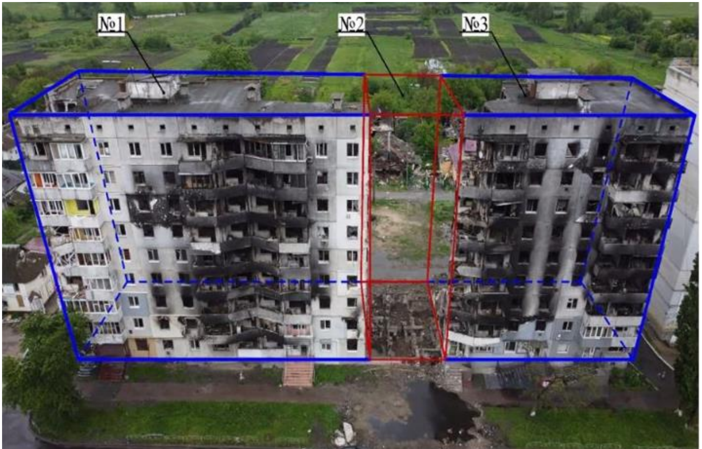
Рис.3.3 Фрагмент огляду пошкодженої будівлі в селі Бородянка
