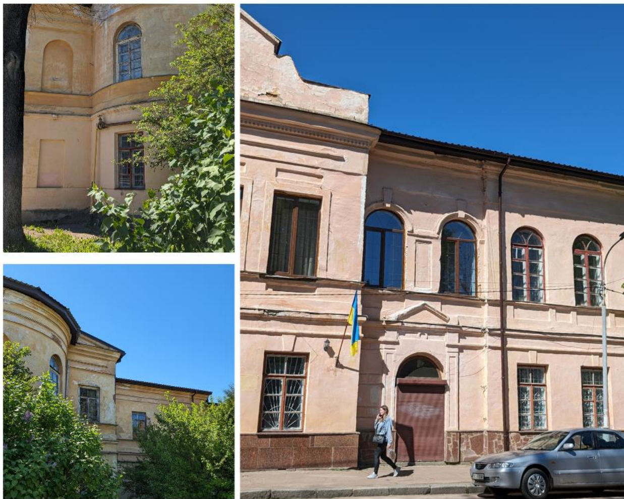
Додаток В.1. Аварійність будівель на вулиці Косенка у Житомирі (фото Н. Огійчук, 2024)
