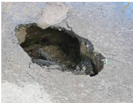
Рис. 5. Провал в асфальті над підземними комунікаціями (м. Ніжин) (фото Філоненка Ю.М.).
