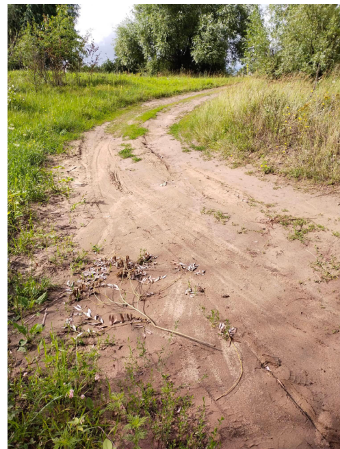
Рис. 2. Ґрунтова дорога на схилі кар'єра (північна околиця м. Ніжин) (фото Філоненка Ю.М.).
