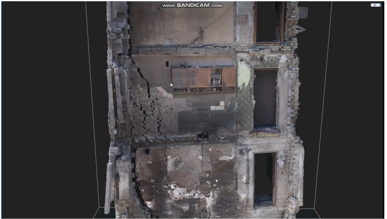
Рис. 3.8. Результати лазерного сканування хмарою точок зруйнованого будинку в м. Бородянка Київської області
