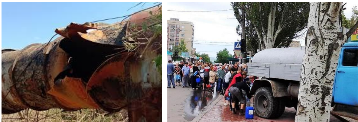
Рис. 6. Пошкодження артобстрілами ділянок трубопроводу каналу Сіверський Донець – Донбас, призводило до припинення водопостачання населених пунктів Донбасу на кілька тижнів (2014-2021 рр.) (джерела [4, 29])
