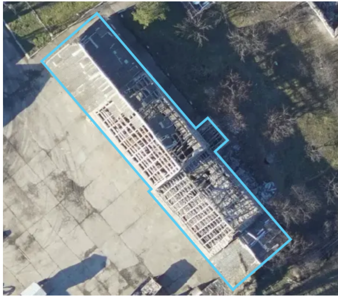
Рис. 3.3 Руйнування перекриття (Відмічено обвали стін та даху) (джерело Marbox)
