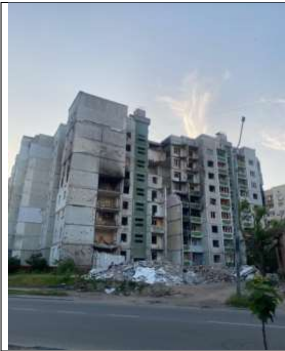
Рис. 2 Будинок на вул. В'ячеслава Чорновола, який зазнав бомбардування 3 березня 2022 року. Фото 9.06.2022
